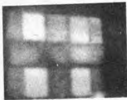
Рис.6.6. Термограмма наружной поверхности двух этажей фасада жилого дома
