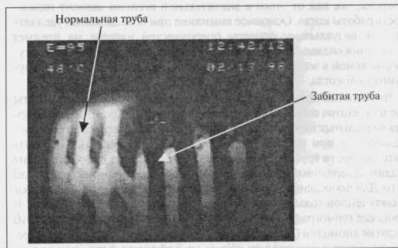
Рис. 16. Термограмма труб поверхности нагрева котла
