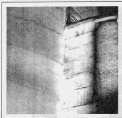
Рис. 14. Термограмма зоны примыкания кирпичного газохода к железобетонной ДТ (температурный градиент в зоне снижения теплозащиты +5^{\circ}\text{C} , в зоне присоса атмосферного воздуха -6^{\circ}\text{C} )
