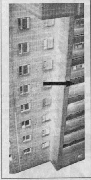
Рис. 5. Термометрия вертикальной стены с отсутствием утеплителя в кирпичном жилом доме (градиент относительно бездефектных швов 4^{\circ}\text{C} ; градиент температуры относительно близлежащей стены 6^{\circ}\text{C} )
