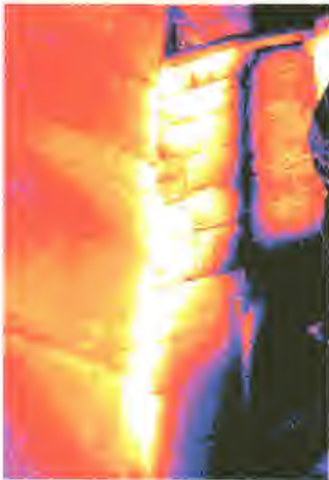
Рис. 11.34. Термограмма зоны примыкания кирпичного газохода к железобетонной ДТ (градиент температуры в зоне снижения теплозащиты +5 °С, в зоне присоса атмосферного воздуха -6 °С)
