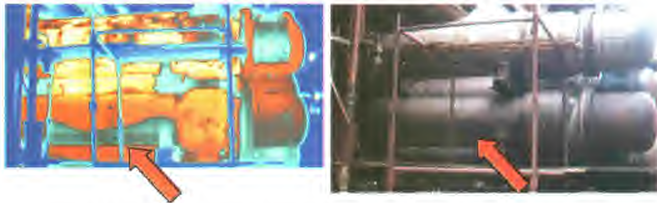
Рис. 11.65. ИК термограмма и фотография теплообменника со значительными отложениями на внутренней стенке (показаны стрелками)
